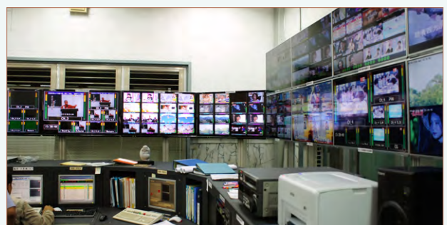
圖11 衛星上鏈機房內監看電視畫面品質情形
