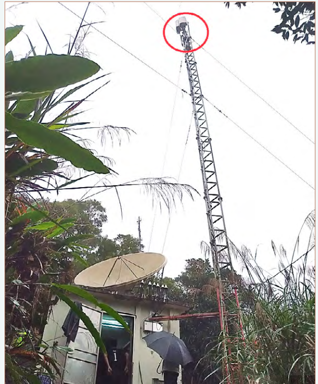
圖9 無線電視改善站外觀及其發射天線
